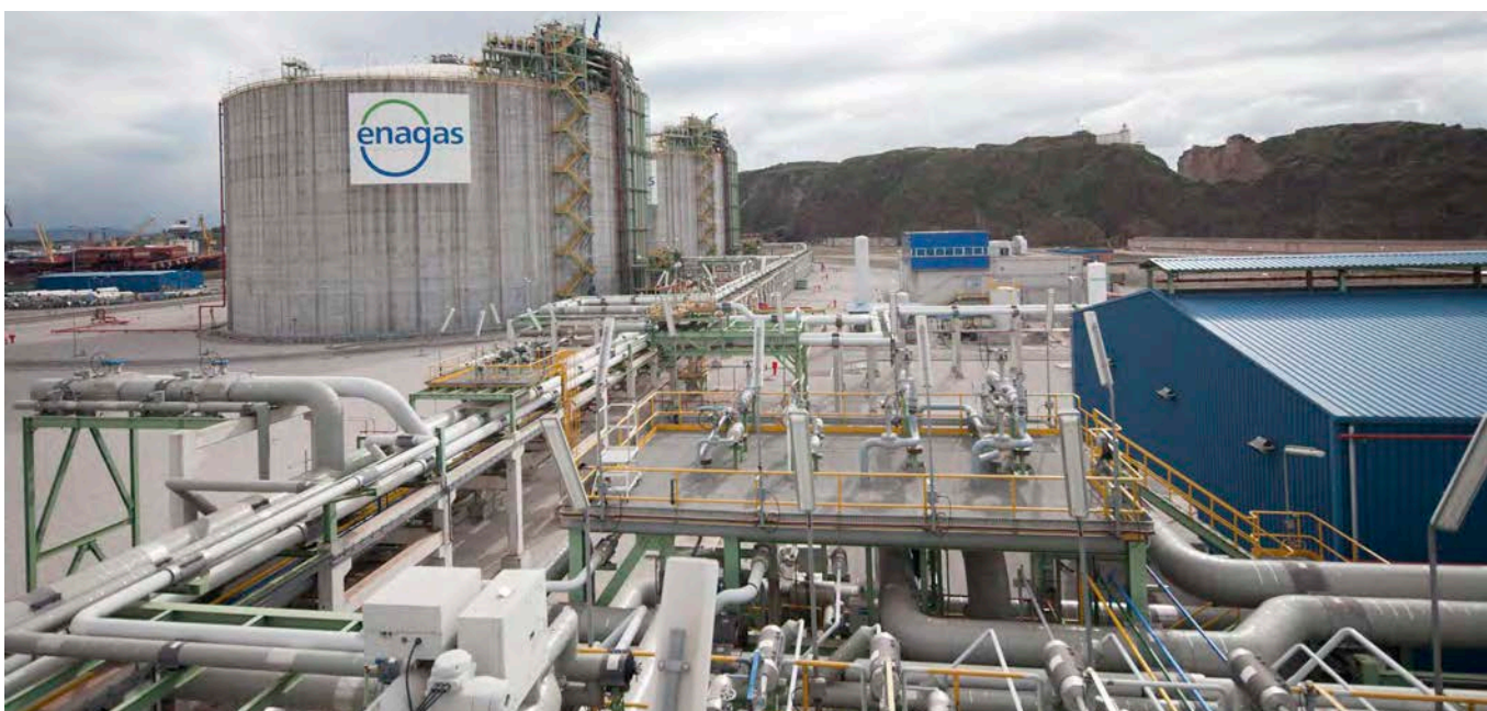
Musel LNG Terminal. Photo courtesy of Enagas
